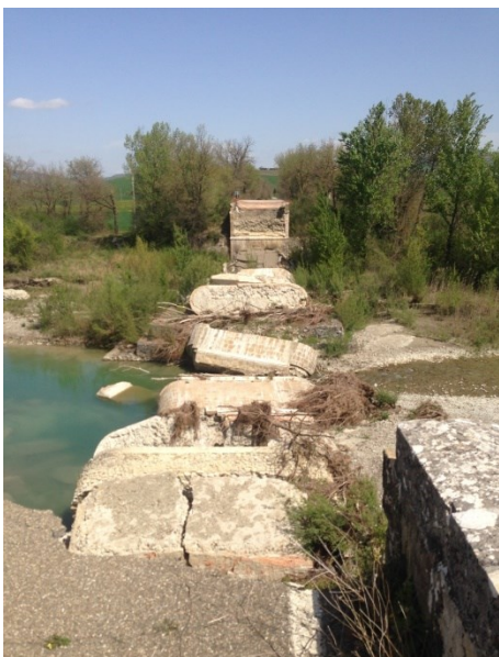
Ponte sull'Orcia – Località Gallina (Crollato per eventi alluvionali 2012)
