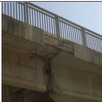
Sella Gaber tipo degradata (Vista laterale)
