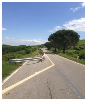
Crollo di sede stradale tipo in numerose strade provinciali
